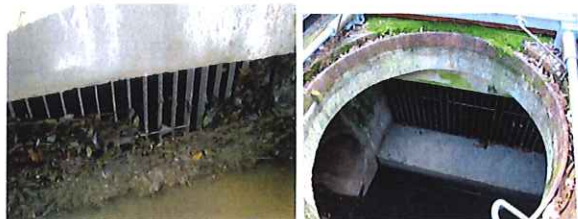
目詰まりしたポンプ場のスクリーン 平常時のポンプ場スクリーン
