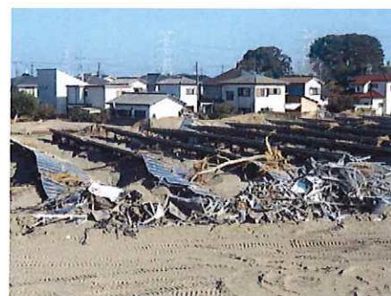
太陽光発電施設 常総市・鬼怒川での被害 (2015,現地調査にて)
