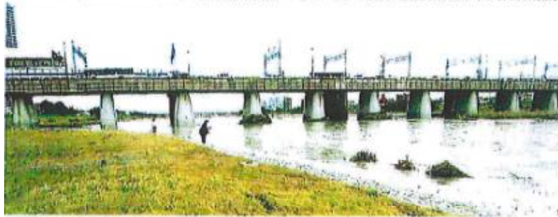
同上地点から多摩川下流を望む。左側に二子玉川駅のホームが見える。橋脚下部には多くの沈木や草が絡みついていた。
