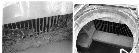
目詰まりしたポンプ場のスクリーン
